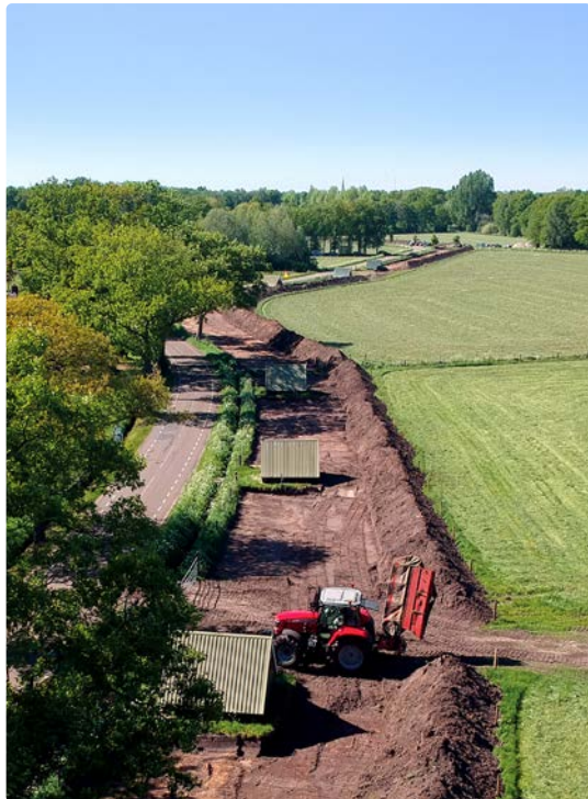
Figuur 59: Leidingen worden zichtbaar en beleefbaar door onderhoud
